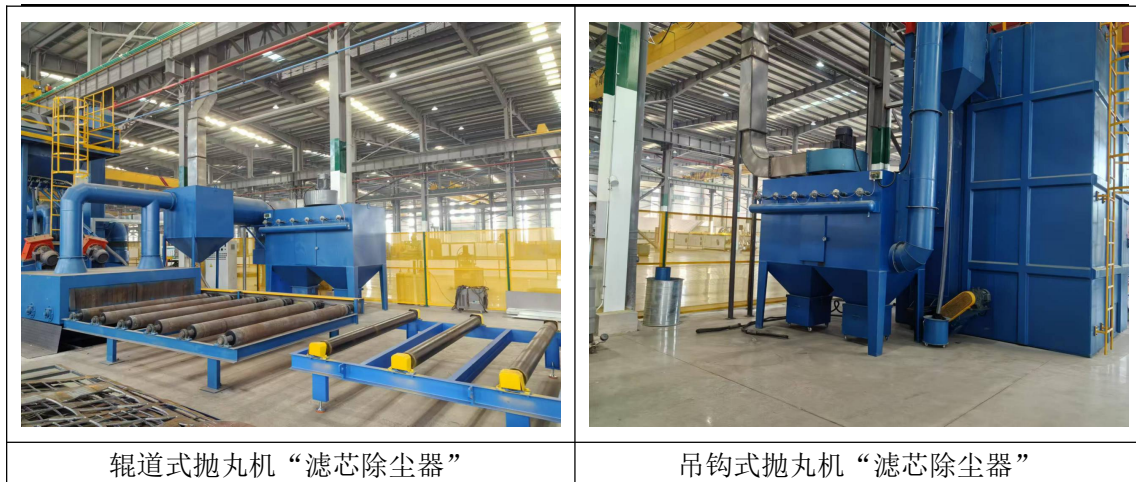
图 4-3 本项目废气处理设施照片
