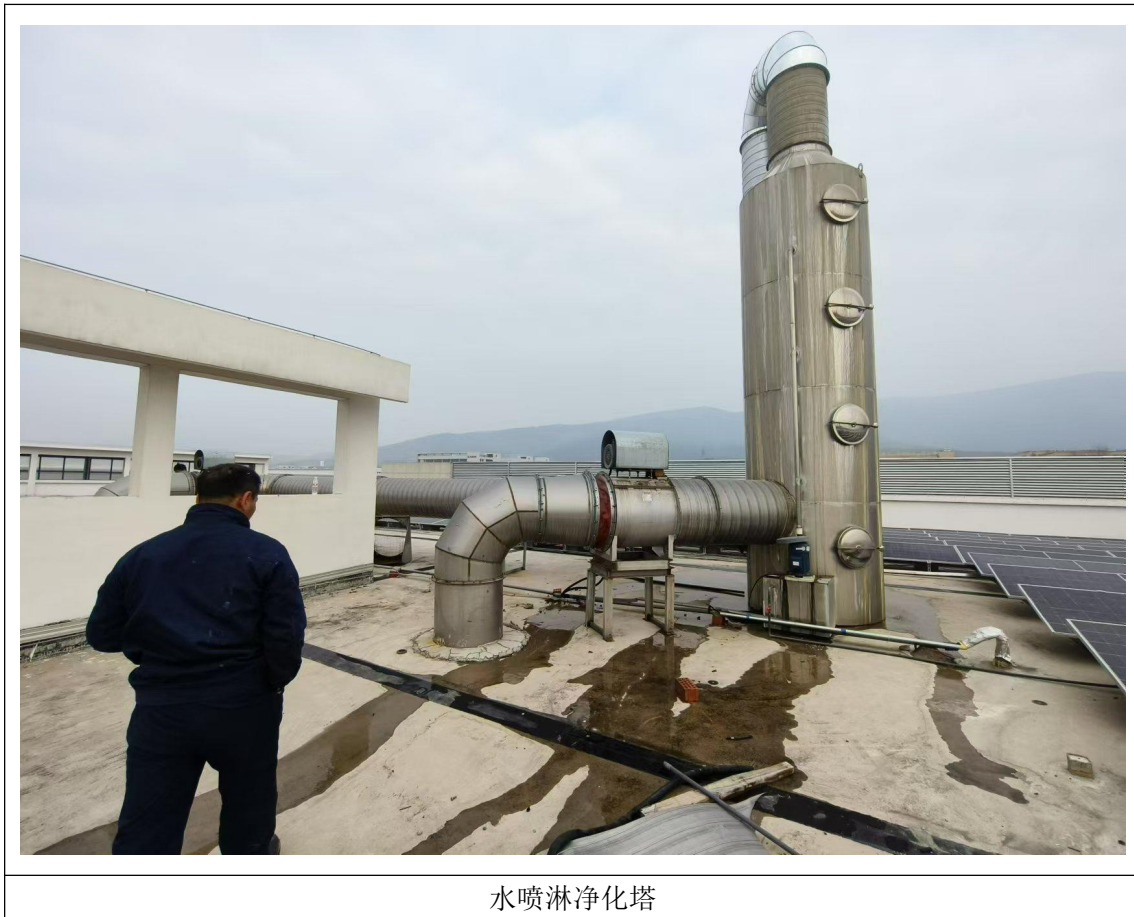
图 4-3 本项目废气处理设施照片
