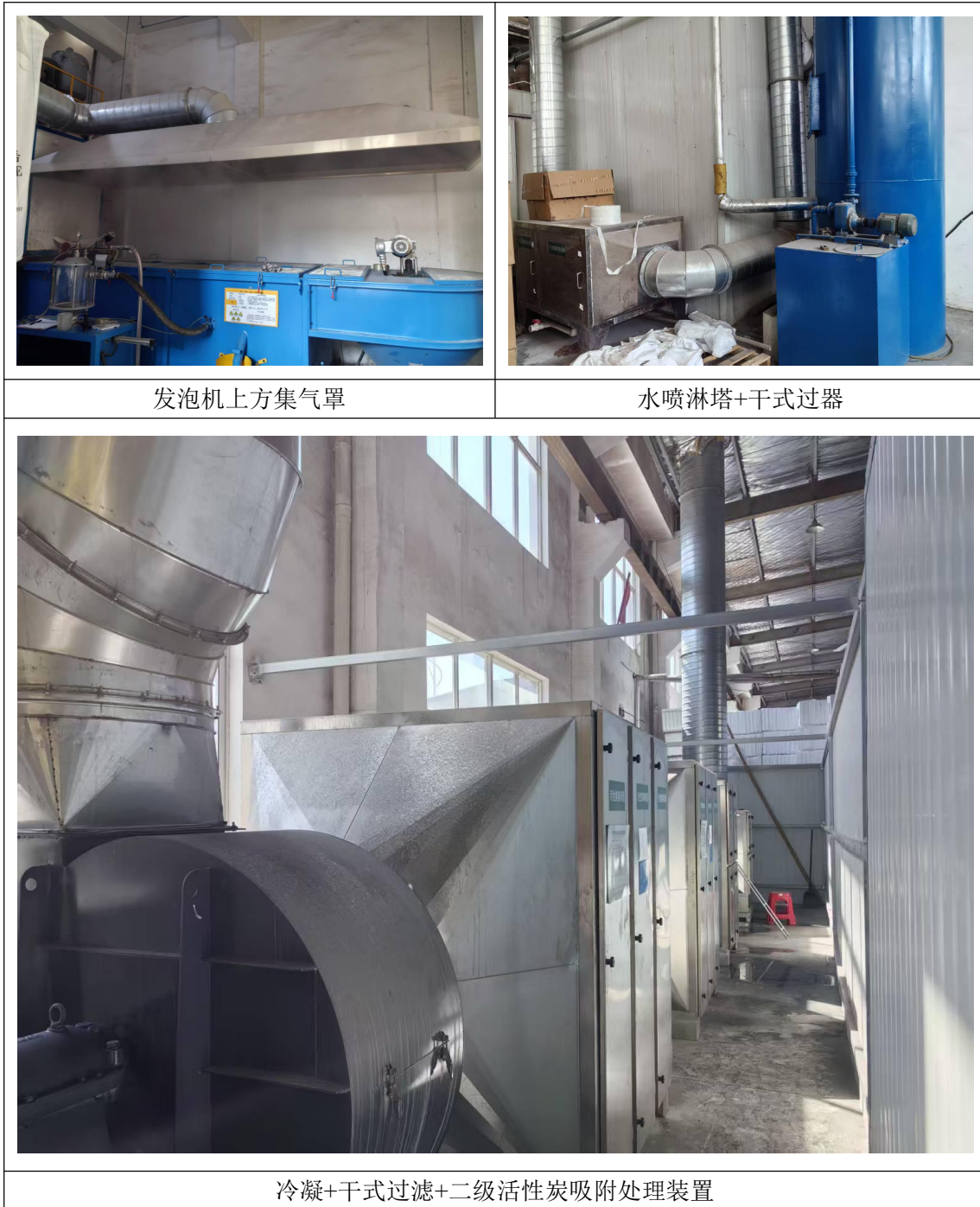
图 4-3 本项目废气处理设施照片
