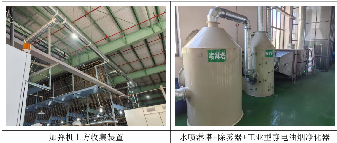
图 4-3 本项目废气、废水处理设施照片
