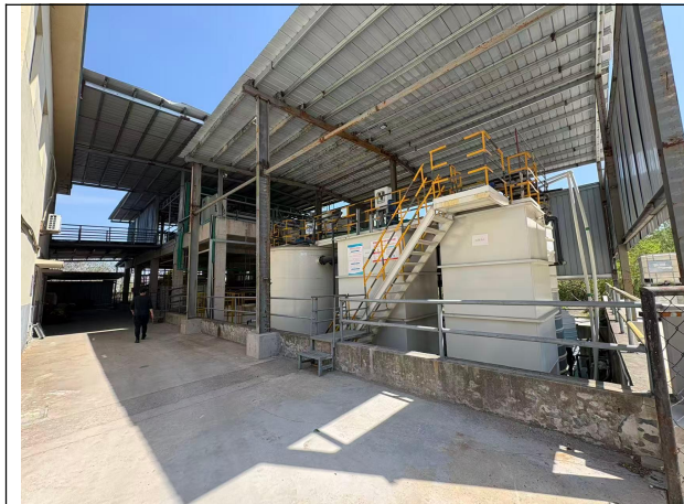
处理设施照片 1
