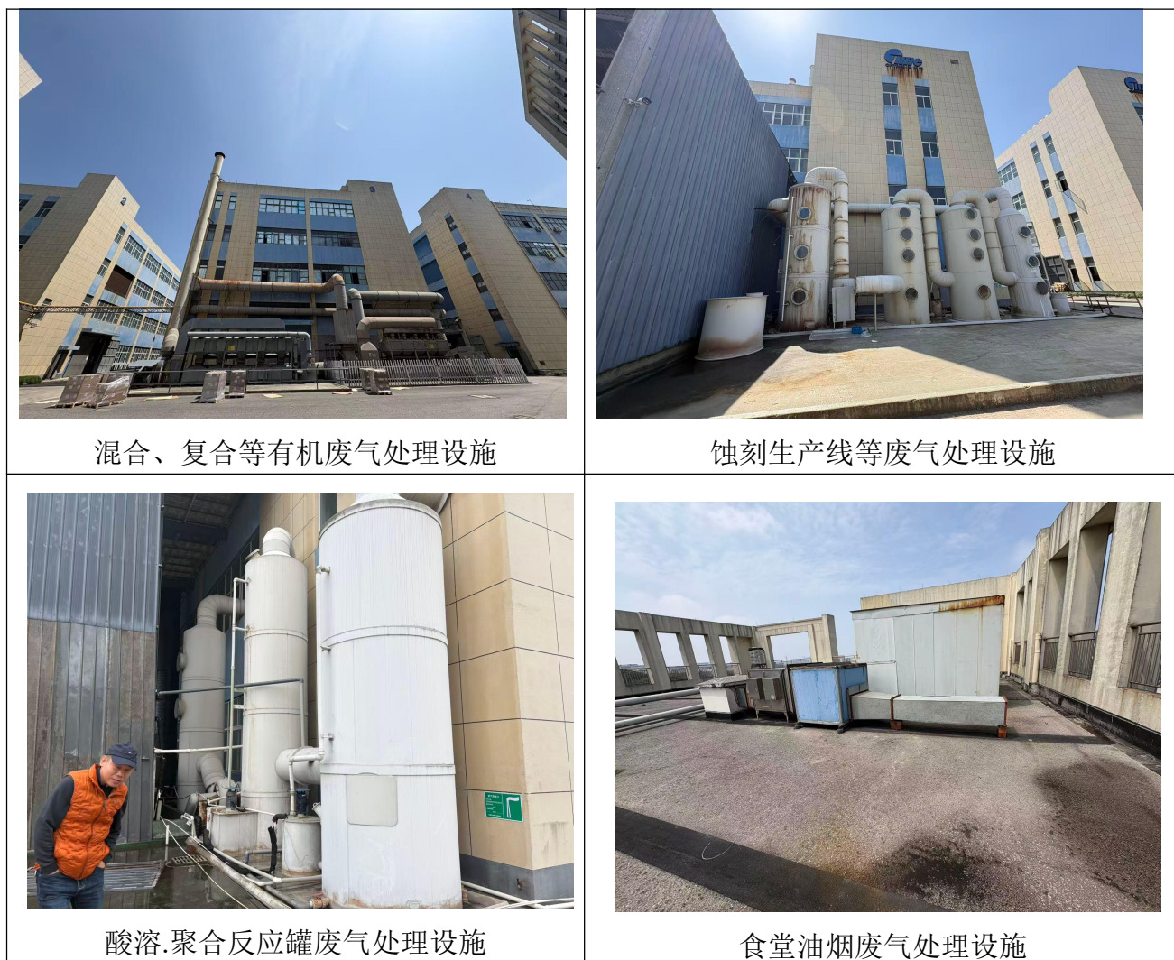
图 4-2 废气处理设施图照片
