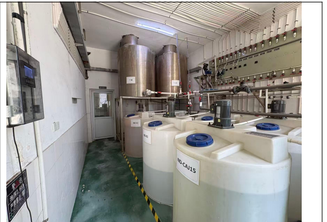
废水处理设施照片 2
