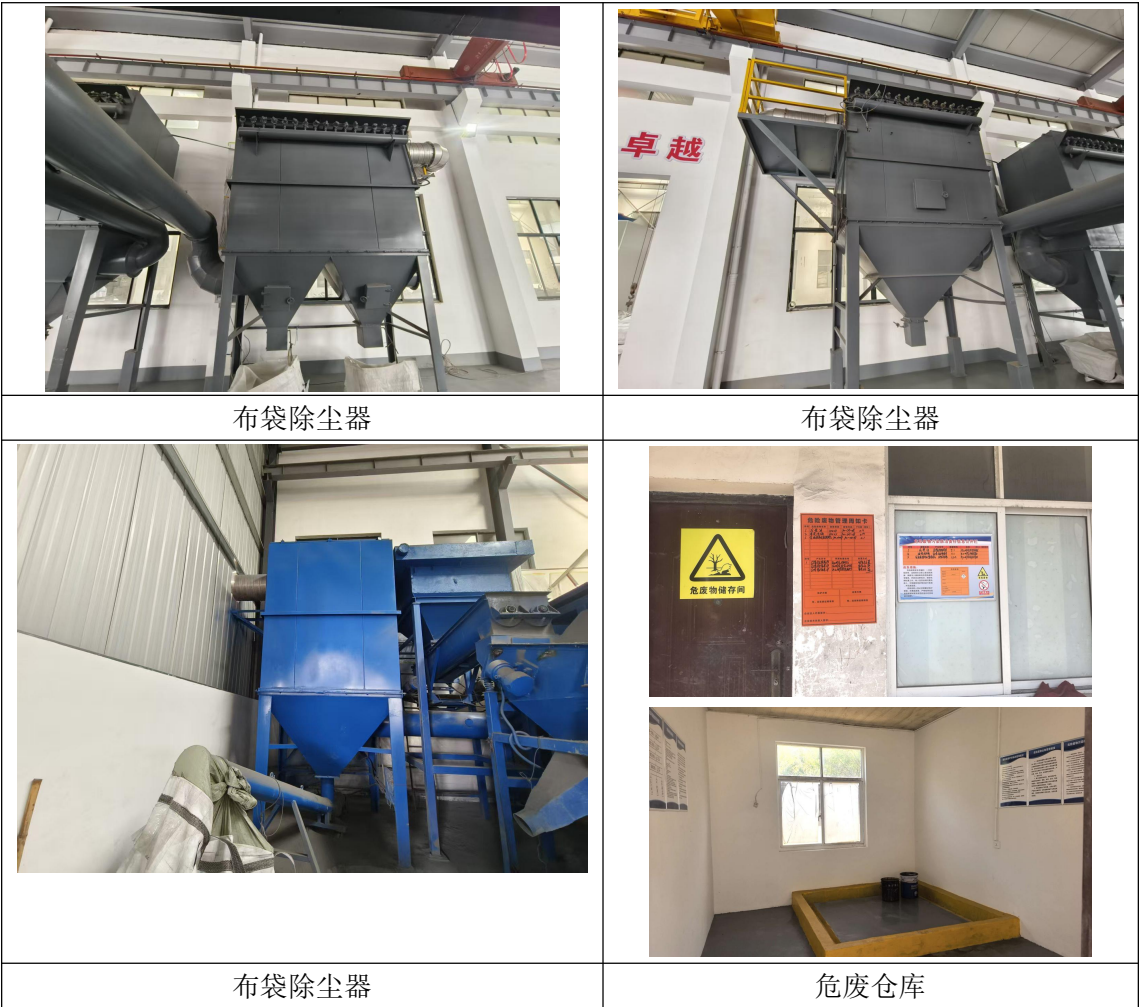
图 4-3 本项目废气处理设施照片
